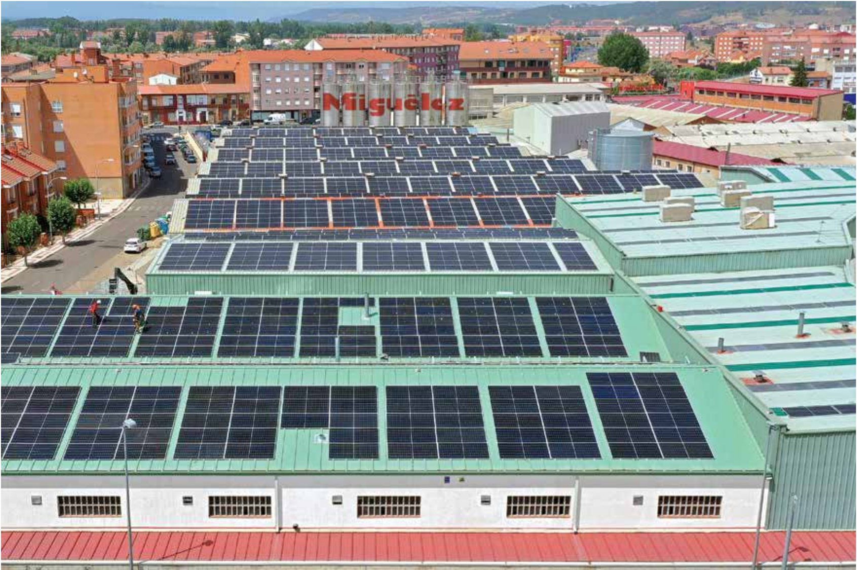
Instalación solar fase 1.
